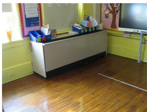
Samuel Smith ES – Unit Ventilator
