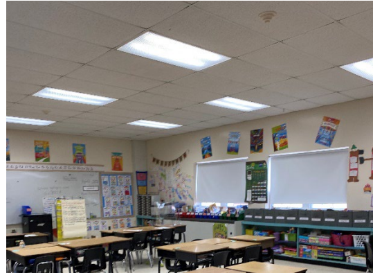
Existing Lighting at E. H. Slaybaugh ES
