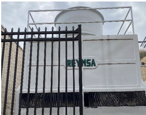
E. H. Slaybaugh PS – Cooling Tower
