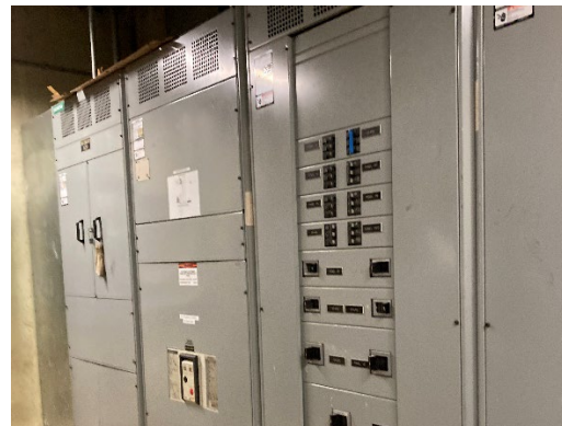
E. H. Slaybaugh ES – Switchboard
