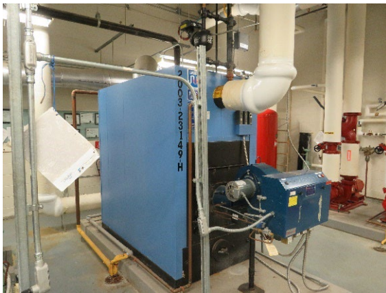
Joyanne D. Miller ES - Boiler
