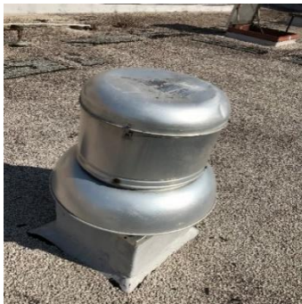
Image 11 Roof exhaust fan
