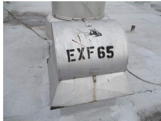
Watchung RHS – Exhaust Fan
